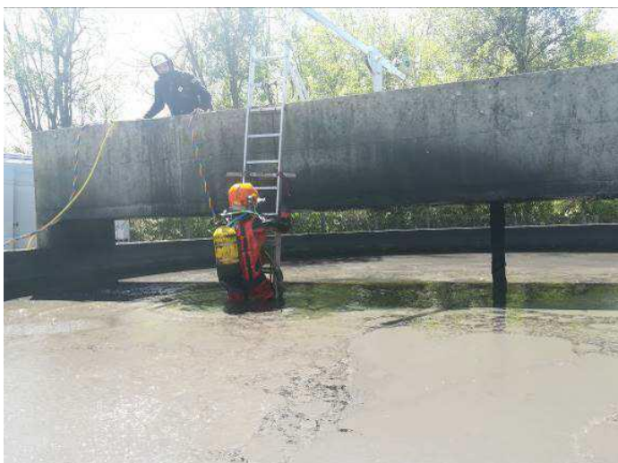
Installation de l'agitateur et des barres de guidage associées
